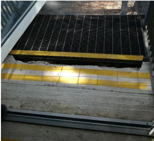
Uscita di emergenza piano primo pad.B
